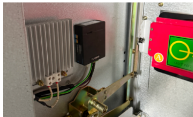
江西井冈山某变电站在线监测
