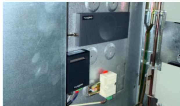
广东广州某变电站在线监测
