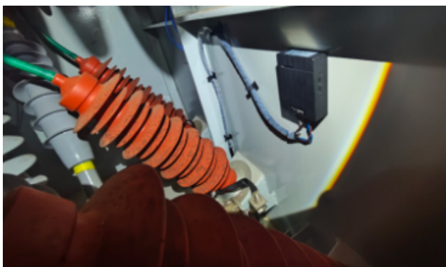
贵州毕节某箱式变压器在线监测
